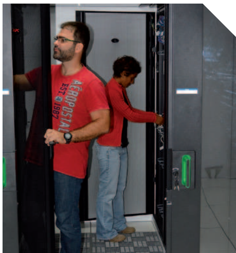
Salle serveur DATA Center
