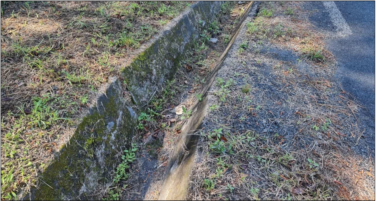
Photo 4 : Vue partielle des désordres impactant le fossé longitudinal
