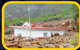
La caserne des pompiers de Waa Wi Luu emportée par une coulée de boue en décembre 2011.
