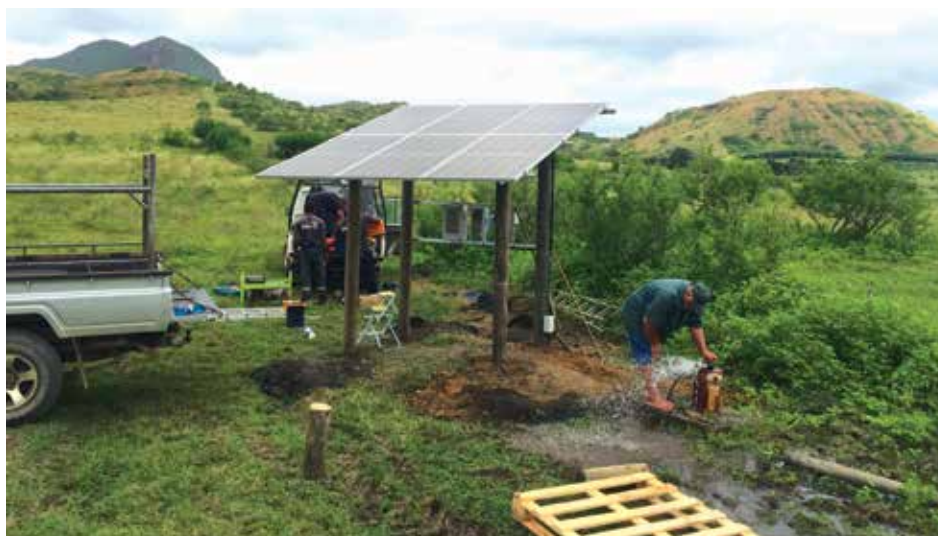
Equipement solaire d'un forage à Pwëbuu (Pouembout)
