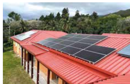
Équipement photovoltaïque du CMS de Pweevo (Pouébo)
