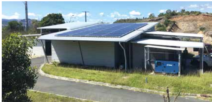
Équipement photovoltaïque de la murisserie de Ouégoa
